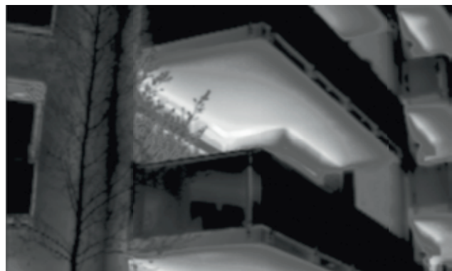
Augmentation de la déperdition de chaleur
