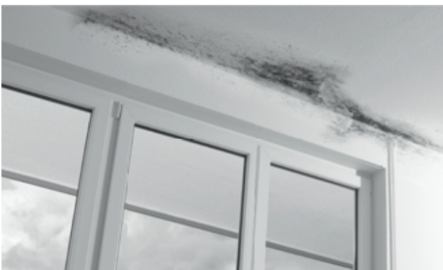
Augmentation du risque de colonisation de moisissures
