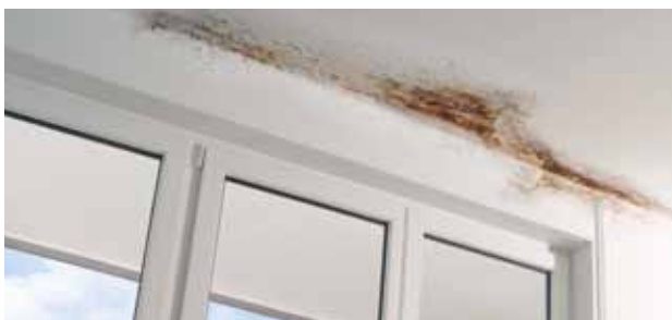
Bouwkundige schade door vocht en schimmelvorming ten gevolge van koudebruggen.
