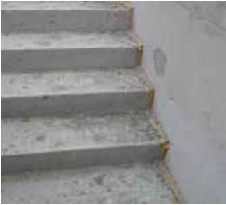
Abb. 8: Zu weiche Materialien bilden die Gefahr von Schallbrücken (sich eindrückende Steine während des Baufortschritts).
