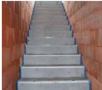
Abb. 7: Die blaue Linie zeigt den schallbrückenfreien Einbau als Qualitätsmerkmal für einen sicheren Schallschutz.
