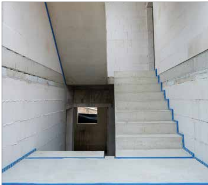
Abb. 50: Die blaue Linie zeigt den schallbrückenfreien Einbau als Qualitätsmerkmal für einen sicheren Schallschutz
