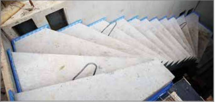
Abb. 84: Die blaue Linie zeigt den schallbrückenfreien Einbau als Qualitätsmerkmal für einen sicheren Schallschutz
