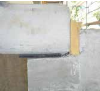
Abb. 2: Schallbrücke durch lückenhafte Baustellenslösungen
