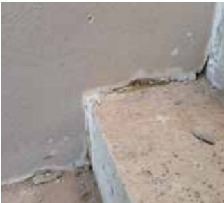
Abb. 4: Schallbrücke durch Folgegewerk
