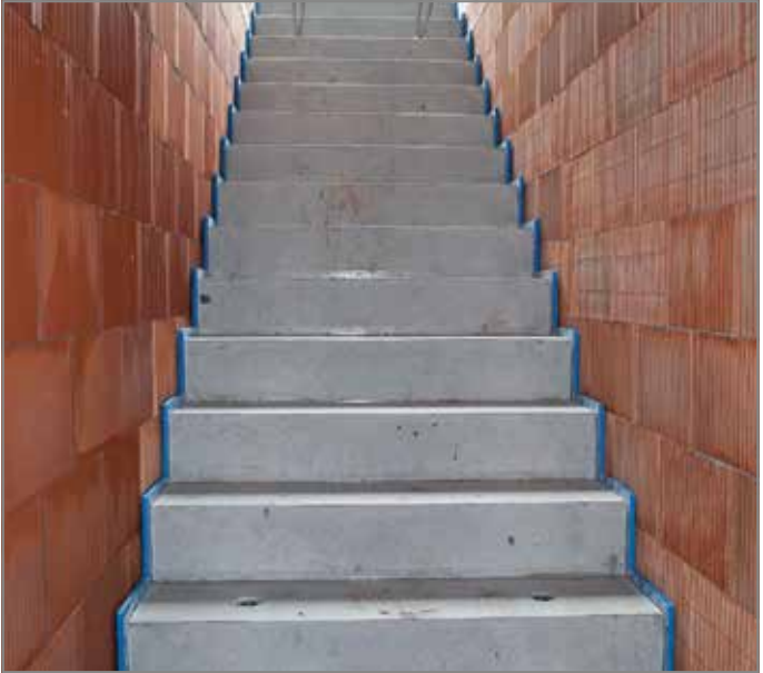
Abb. 146: Die blaue Linie zeigt den schallbrückenfreien Einbau als Qualitätsmerkmal für einen sicheren Schallschutz.
