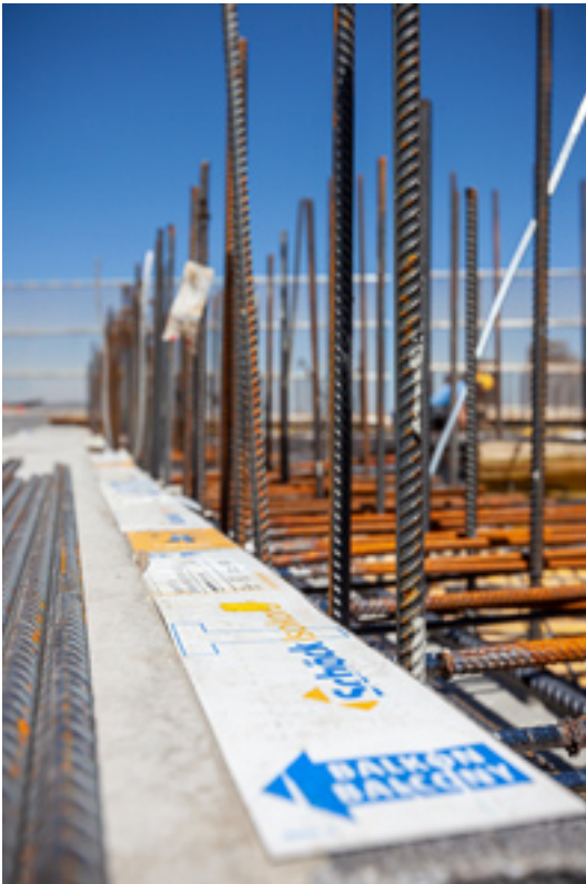
Verschiedene Typen des tragenden Wärmedämmelements Schöck Isokorb lösten statische Herausforderungen im Wiener Projekt Q-Tower Wien. Foto: Markus Schieder
