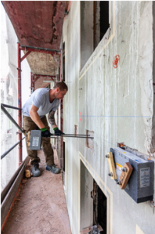
Die Balkone wurden in einer Holz-Stahl-Konstruktion mit Schöck Isokorb RT Typ SK an die Bestandsfassade gebaut. Foto: Markus Schieder
