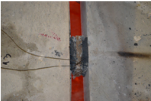
Die Brandschutzmanschette des Stacon Typ SLD – hier im Bild nach einem Brand – schützt den Stahl vor der Hitzeeinwirkung. Foto: Schöck Bauteile GmbH
