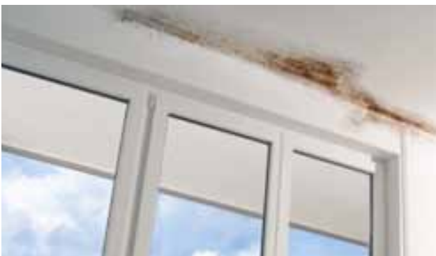
Augmentation du risque de colonisation de moisissures
