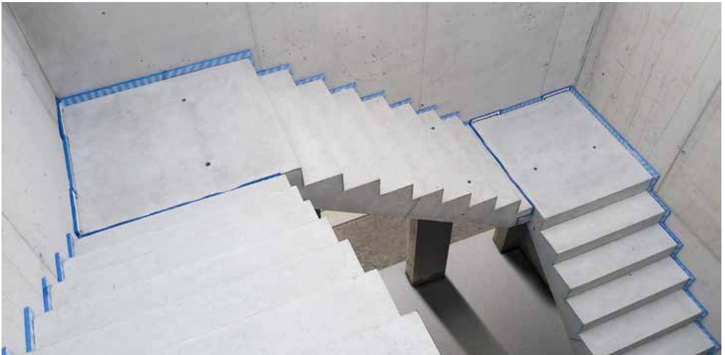
Abb. 15: Die blaue Linie zeigt den schallbrückenfreien Einbau als Qualitätsmerkmal für einen sicheren Schallschutz.
