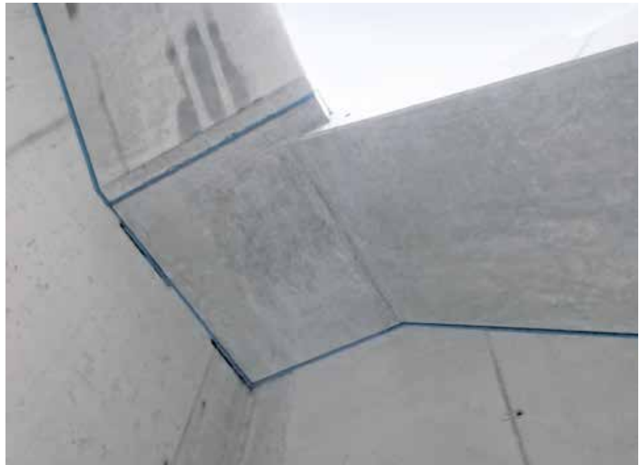
Abb. 14: Gleichmässige blaue Linie im Fugenbereich
