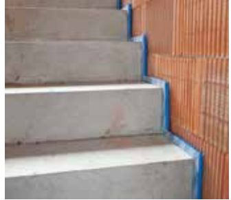
Abb. 8: Korrekte Ausführung – Schöck Tronsole® trennt die Bauteile vollflächig und minimiert die Gefahr von Schallbrücken.
