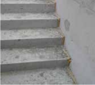
Abb. 7: Mangelhafte Ausführung – zu weiche Materialien bilden die Gefahr von Schallbrücken (sich eindrückende Steine während des Baufortschritts).
