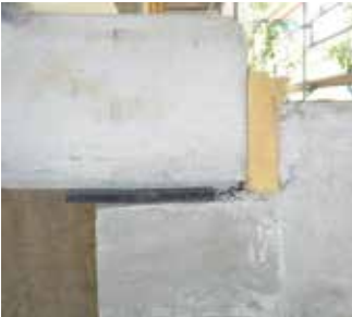
Abb. 1: Mangelhafte Ausführung – Schallbrücke durch lückenhafte Baustellenlösungen
