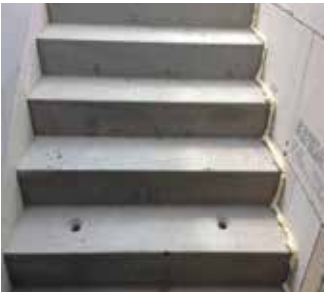
Abb. 5: Mangelhafte Ausführung – zu harte Materialien können zu einer deutlichen Verschlechterung der Schalldämmung führen.
