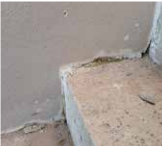
Abb. 3: Mangelhafte Ausführung – Schallbrücke durch Folgewerk
